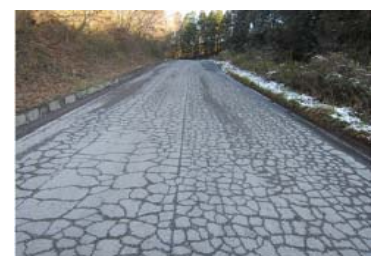
(損壊した道路の状況)
